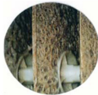
汚泥付着状態
